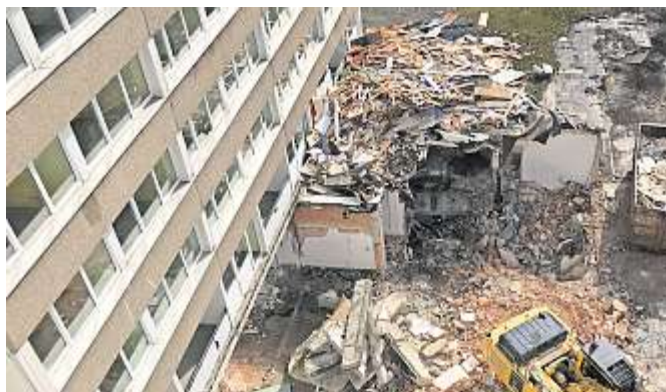
Die Hotel-Anbauten liegen bereits in Trümmern.
