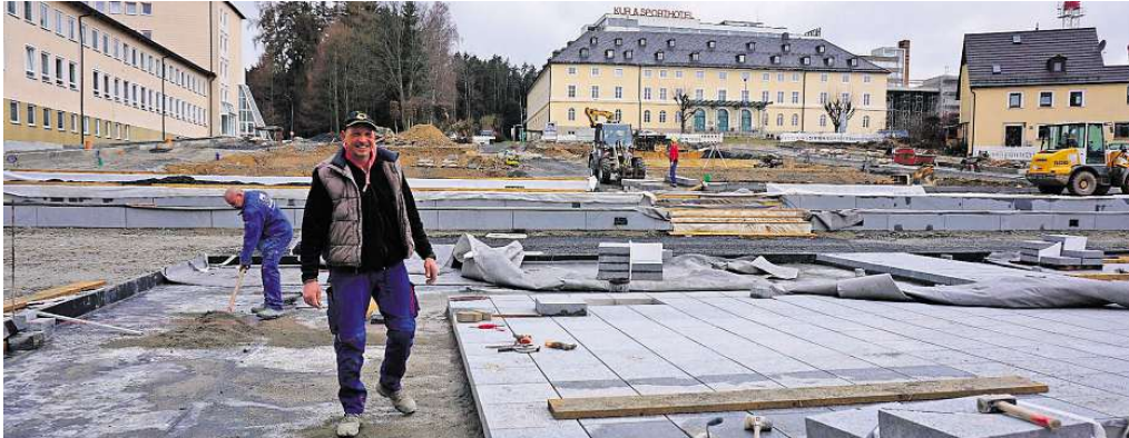
Die Arbeiten an den Schlossterrassen in Bad Alexandersbad starten in die entscheidende Phase. Bis 1. Juli soll der repräsentative Platz neuer Mittelpunkt im Ort sein.
